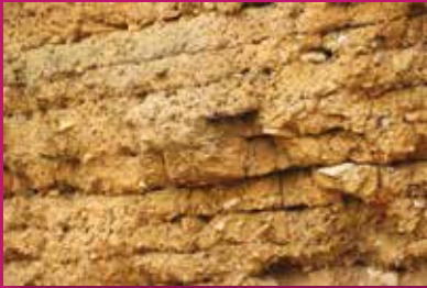
Le rempart nécessite des travaux d'urgence
